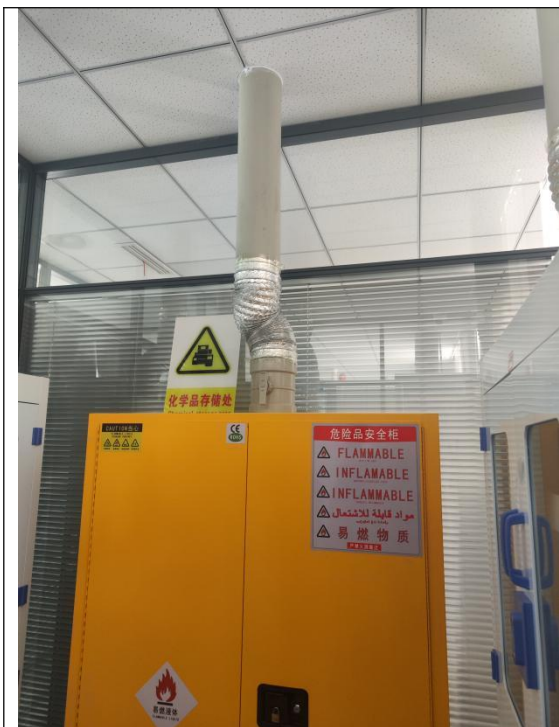
危险化学品药剂储存柜
