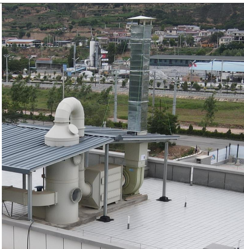
废气处理装置
