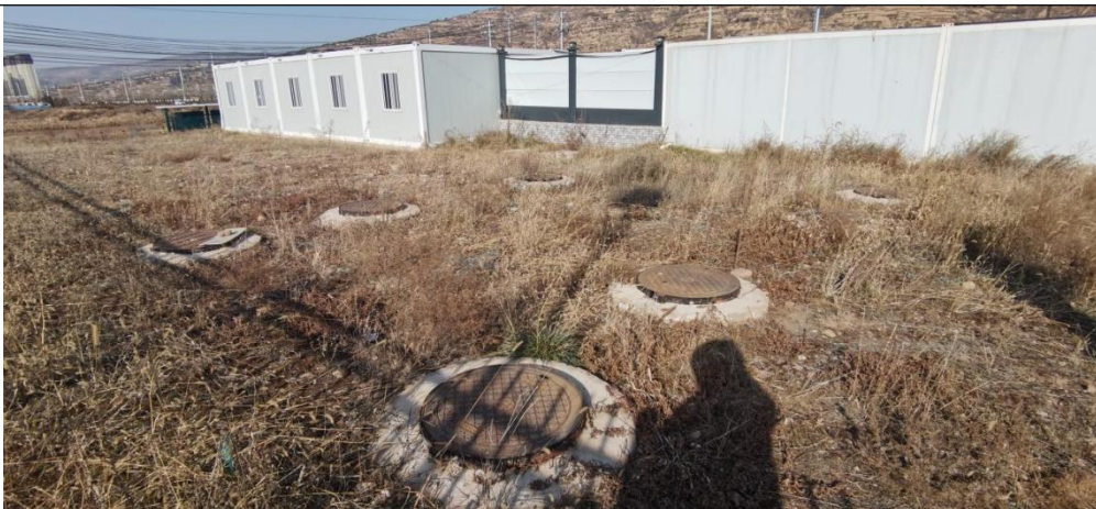
废水处理设施（化粪池）
